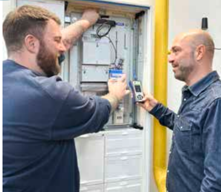
Smart-Meter-Gateway im Test. Sebastian Tacke (r.) und Zählermonteur Valentin Berse testen die Einrichtung.
